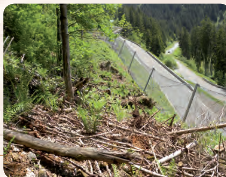
Filets pare-pierres dans le Col de Morgins.
