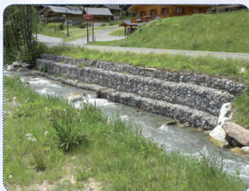
Mesure de protection : gabions dans le secteur du Linga (route de Pré-la-Joux).
