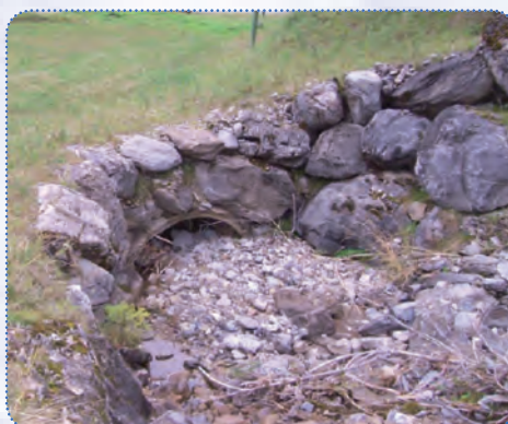
Buse obstruée par les matériaux du ruisseau des Combes à Pré-la-Joux.
